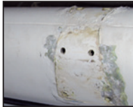
Mât en alu corrodé
